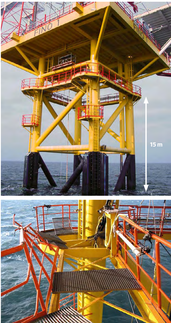
Extremwetterlagen: Schäden an der Messplattform FINO vor Borkum an der Deutschen Küste durch mehr als 15 m hohe Wellen (1. November 2006, Orkan Britta) (Fotos: BSH)
